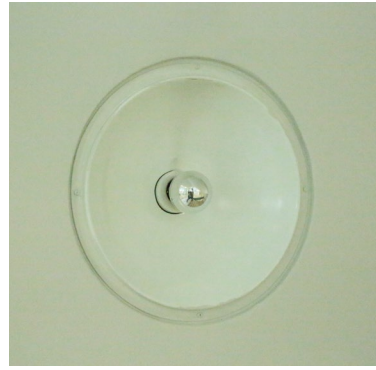
↑ Porrashuoneen seinään upotettu valaisin on Ruusuvuorelle tyypillistä pelkistettyä detaljikkää.
